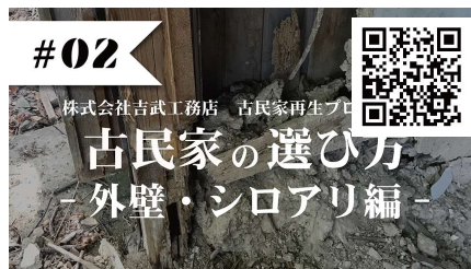
△古民家選びで重要なポイント～外壁・シロアリ編～
